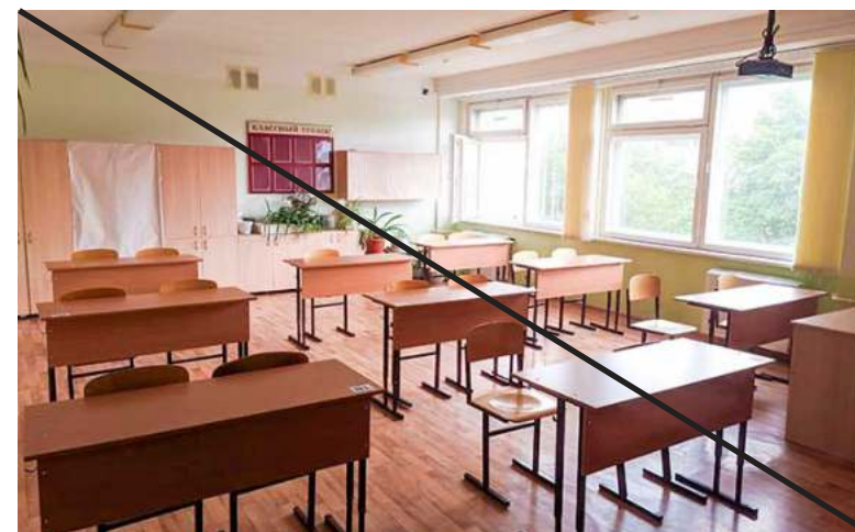
Плохо Линолеум под дерево
